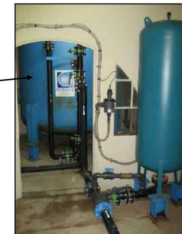
Traitement de reminéralisation
