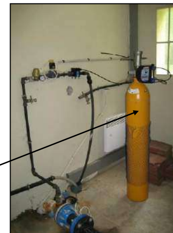
Traitement au chlore gazeux
