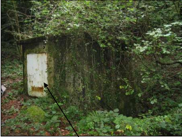
Porte d'accès fermant à clé avec aération grillagée
